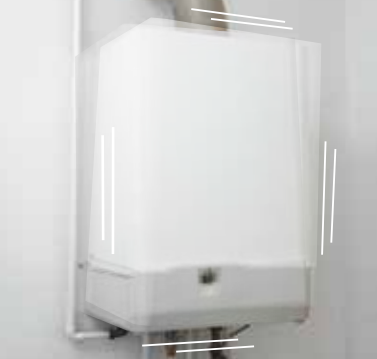
Une chaudière défectueuse ?
